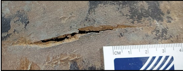
Figure 6. Point de rupture sur la conduite de DN 16 (Source : Acuren)
