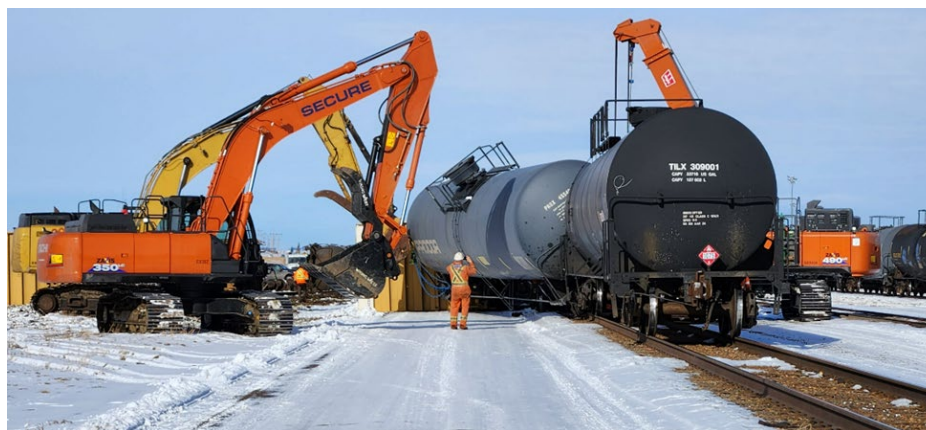
Figure 4. Wagon-citerne déraillé après la collision (Source : BST)
