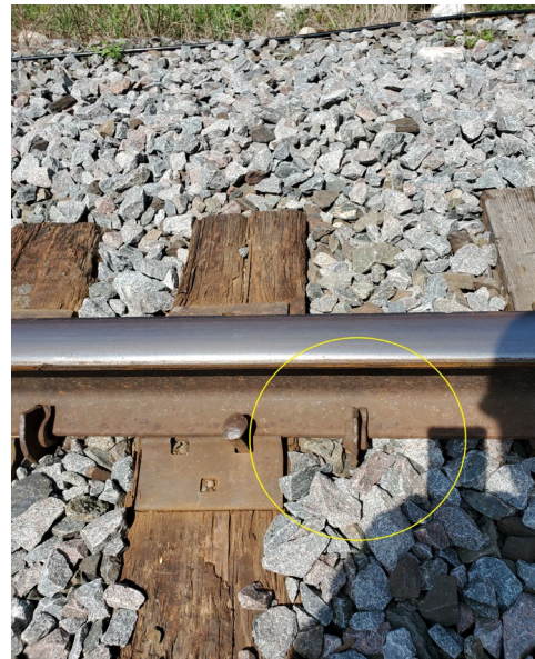
Figure 4. La voie d'évitement adjacente au point de déraillement, avec un anticheminant à plusieurs pouces des traverses (Source : BST)
