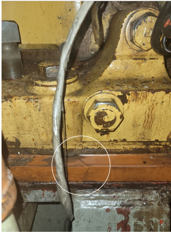
Figure 10. Photo en gros plan du support du moteur, montrant une deuxième fissure sur le support du moteur avant bâbord près des boulons (Source : BST)
