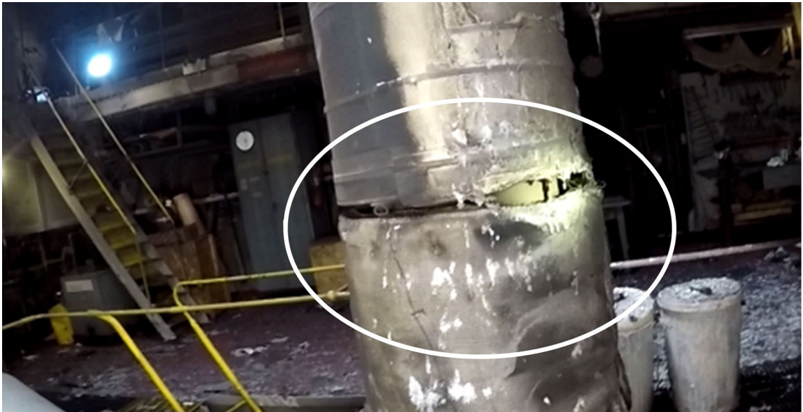
Figure 12. Vue de profil de l'isolation du turbocompresseur montrant les espaces laissés par l'installation de l'isolant sur la sortie du turbocompresseur (Source : BST)
