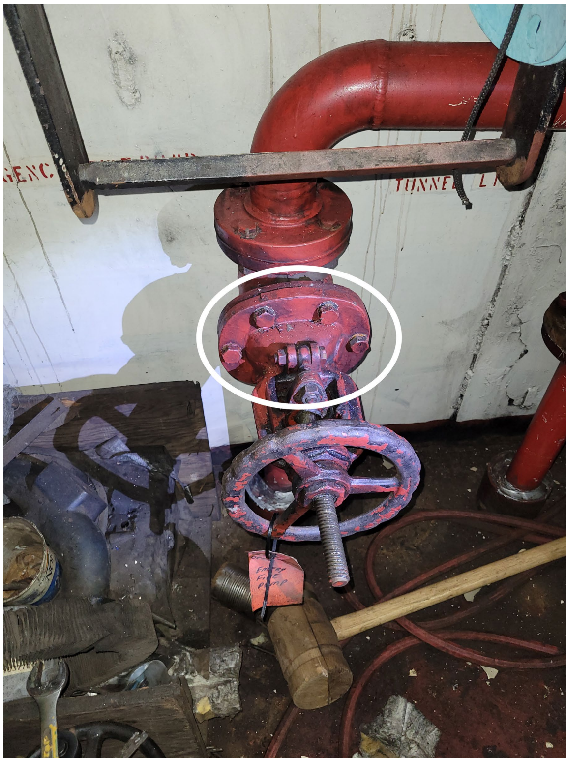
Figure 19. La vanne d'isolement, en place (Source : BST)
