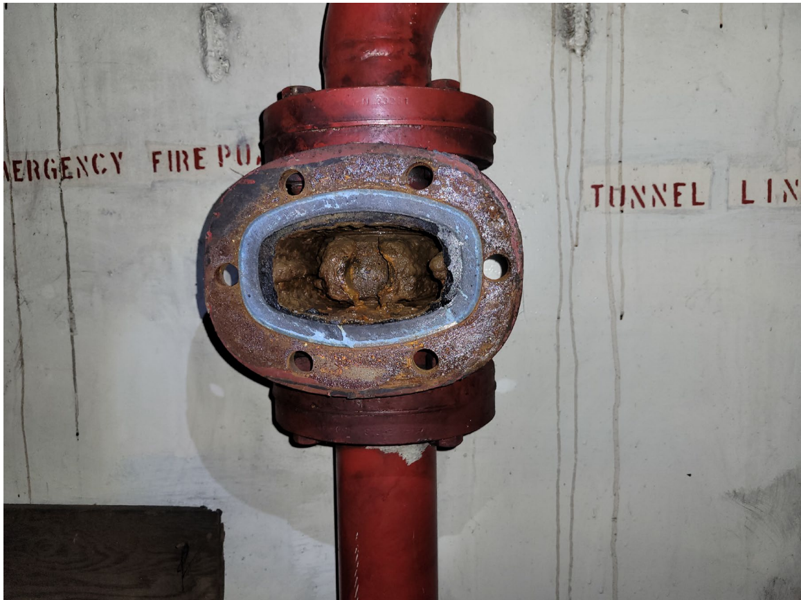
Figure 21. La vanne d'isolement, montrant l'opercule déconnecté (Source : BST)
